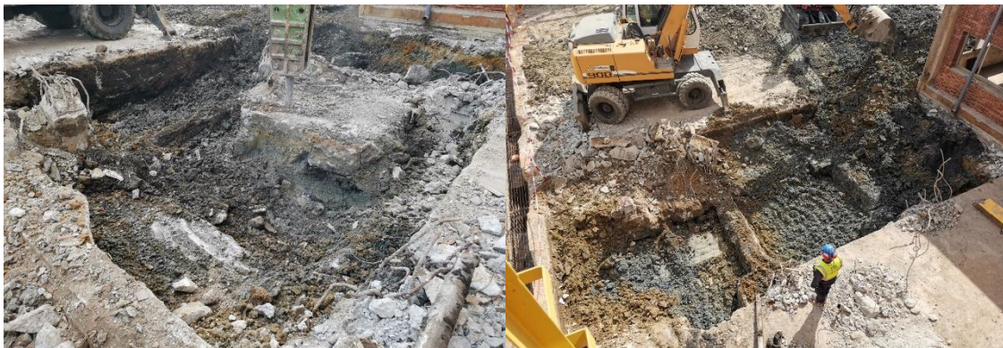
Lámina 3 y 4. Restos de afecciones.
